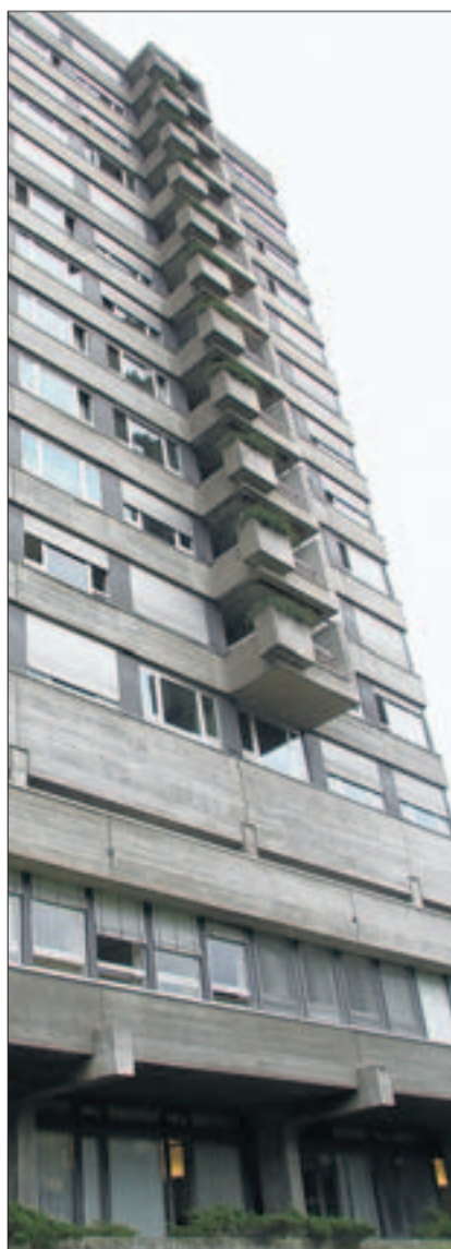
Das Spital Limmattal braucht dringend Sanierungen: Innen wie aussen. (fio)
